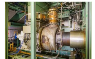
【アンモニアガスタービン】
