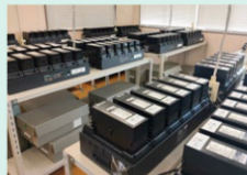
バッテリー保管・充電施設
