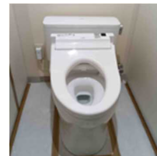
トイレ衛生機器
