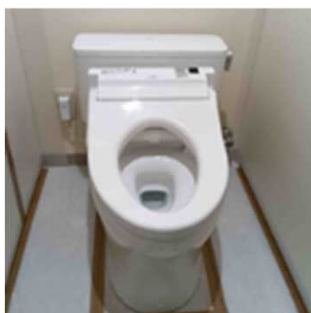
トイレ衛生機器
