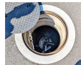
帯水層蓄熱システムの熱源井
