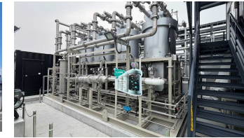
CO 2 回収装置外観
