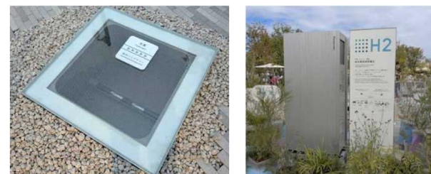
水素供給パイプラインと 供給先の水素燃料電池
