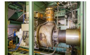
【アンモニアガスタービン】
