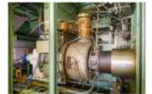
【アンモニアガスタービン】
