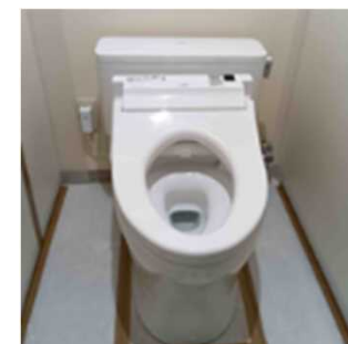
トイレ衛生機器
