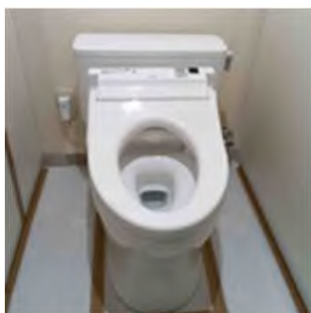
トイレ衛生機器
