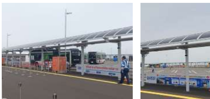
図 3-2-9 夢洲第1交通ターミナルに設置されたペロブスカイト太陽電池付バスシェルター
