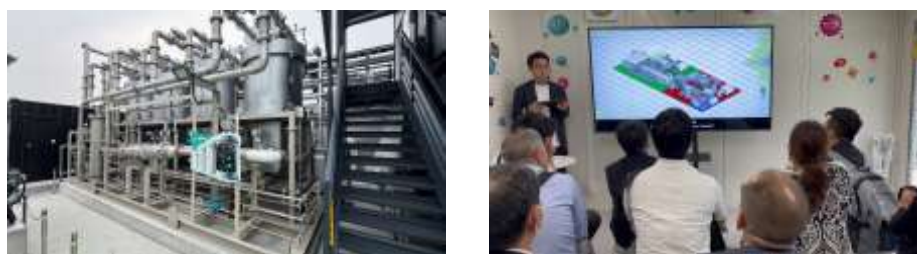
図 3-2-15 地球の恵みステーション CO 2 回収装置及び見学ツアーの様子
