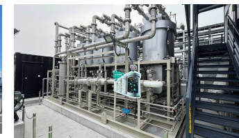
CO 2 回収装置外観
