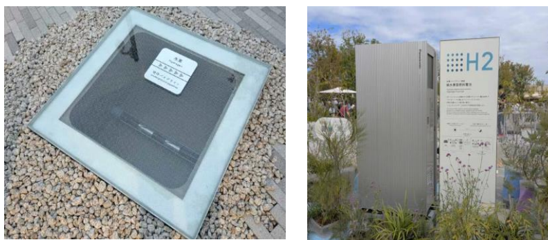
図 3-2-7 水素供給パイプラインと供給先の水素燃料電池
