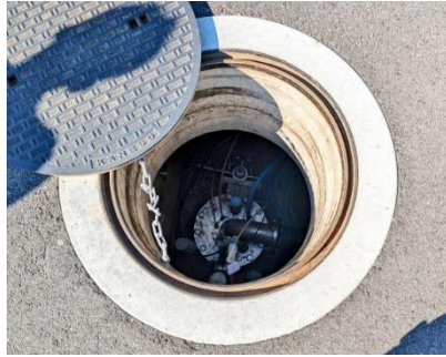
図 3-2-11 会場内に実装された帯水層蓄熱システムの熱源井
