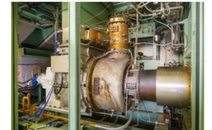
【アンモニアガスタービン】
