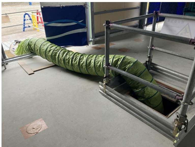
〔図 17: 作業中の地下ピットの機械換気〕
