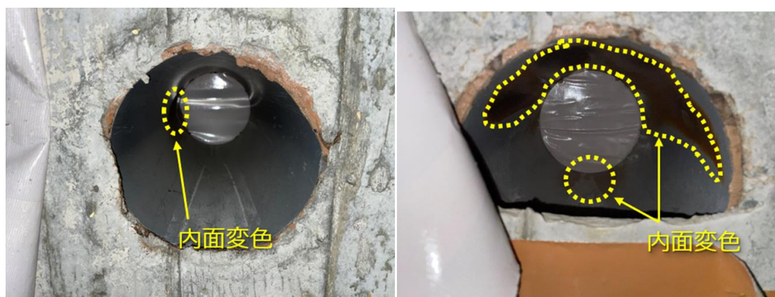
[図 15—3: 地下ピット内基礎梁部スリーブ損傷箇所]
