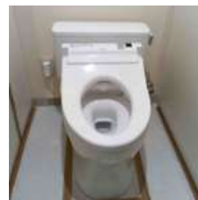
トイレ衛生機器
