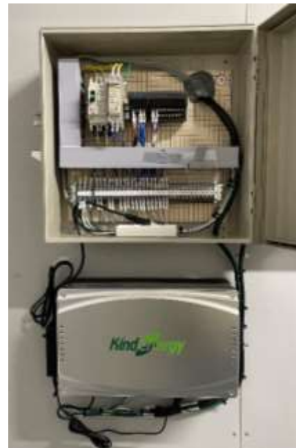
パビリオンに設置したK-BOXと制御盤
