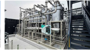
CO 2 回収装置外観
