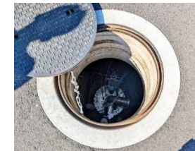
帯水層蓄熱システムの熱源井
